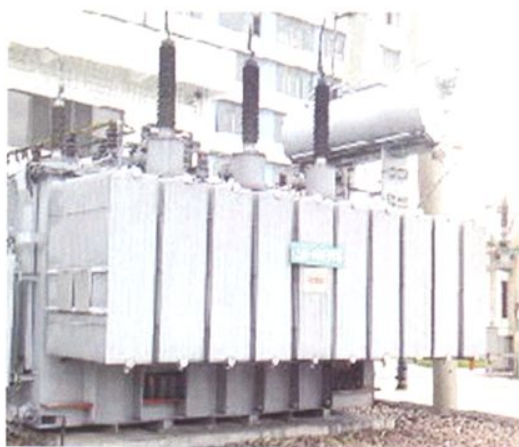
2001 年 12 月，水头变电站增设的 5 万千瓦主变设备
