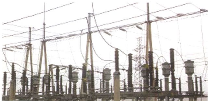
大沥供电所 11 万伏变电站
