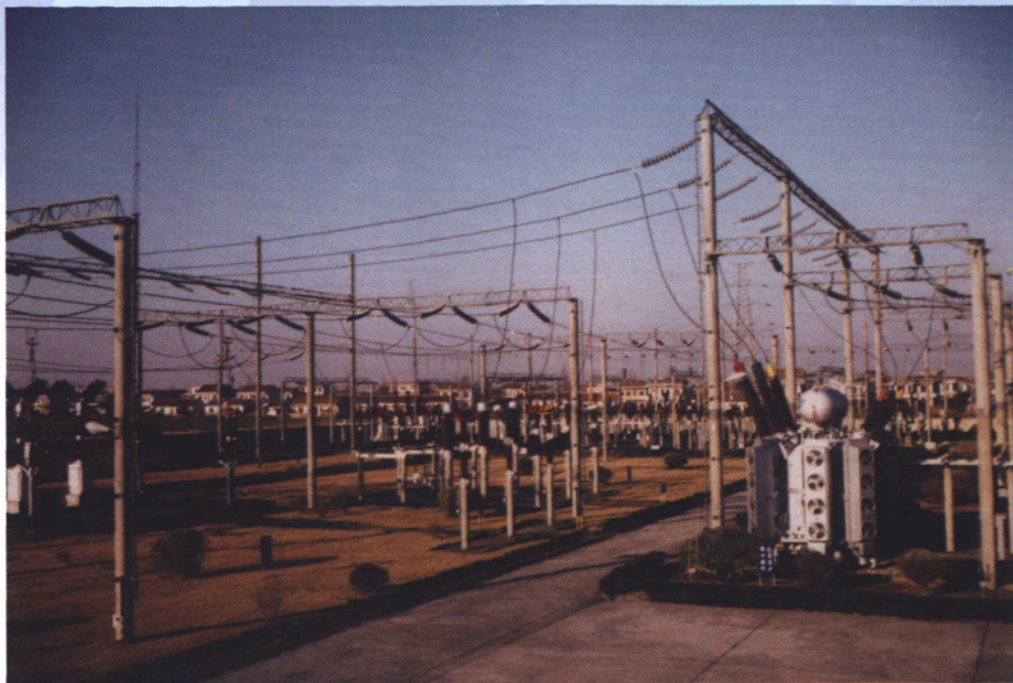
1994年12月20日建成投入试运行、1995年5月12日正式投运的220千伏汇龙变电所
