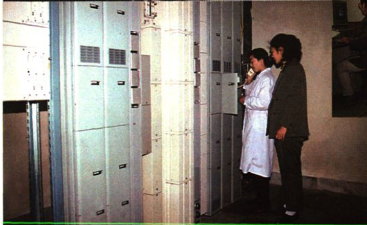
农话光缆终端机房
