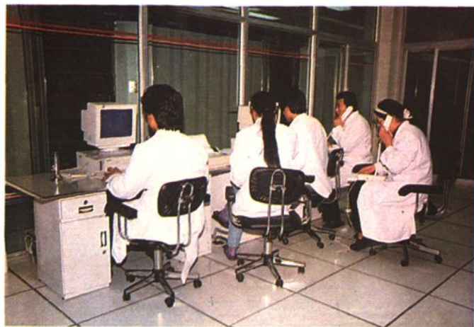
区局程控机房
