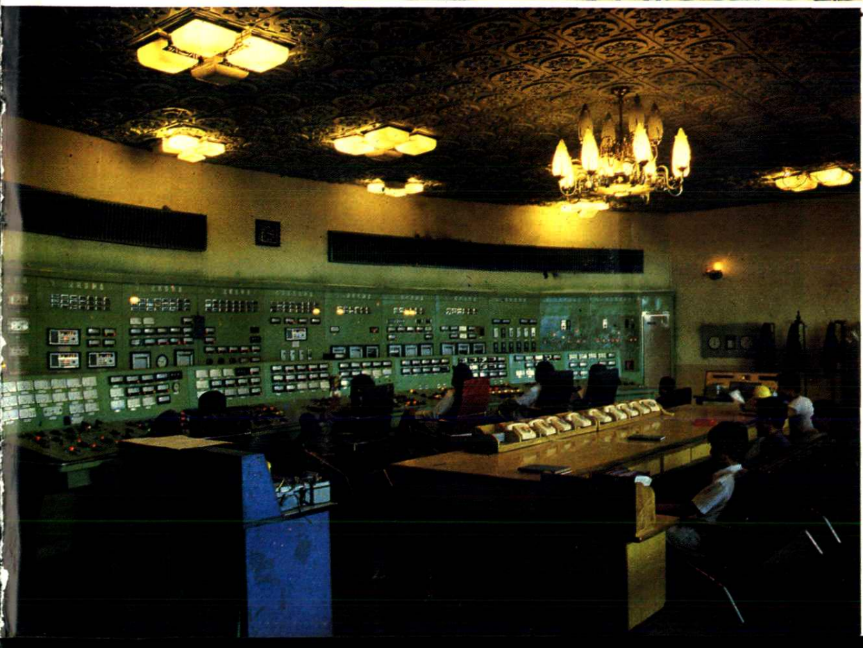
新华发电厂发电机组控制室
