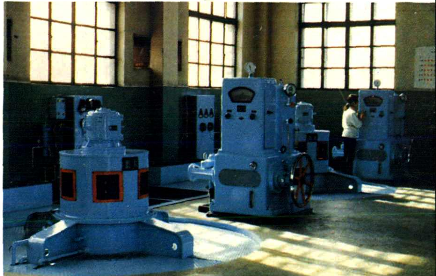
牡丹江第二发电厂电力实业公司水电站
