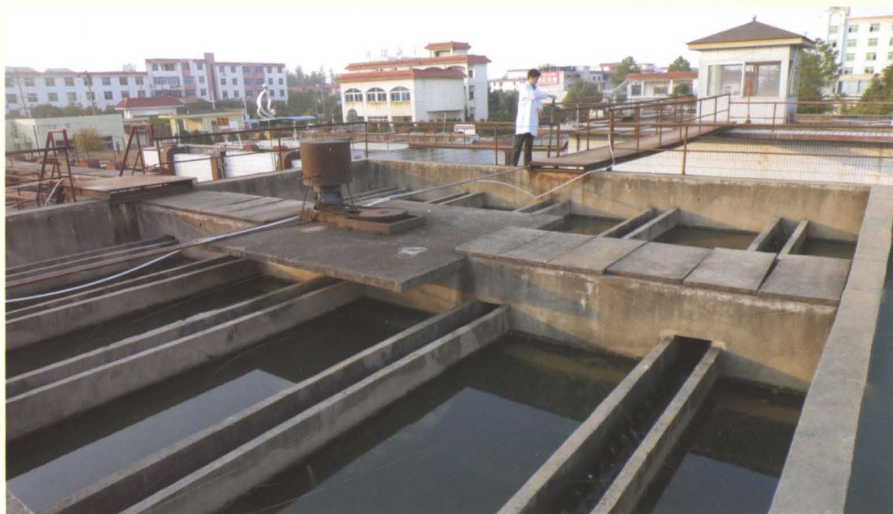
县自来水总公司净水设施
