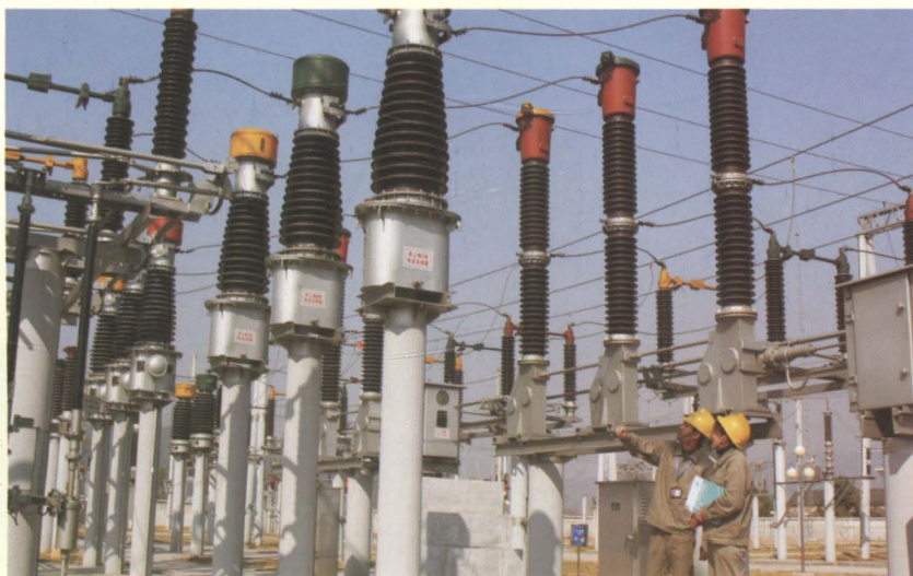
上田110千伏变电站
