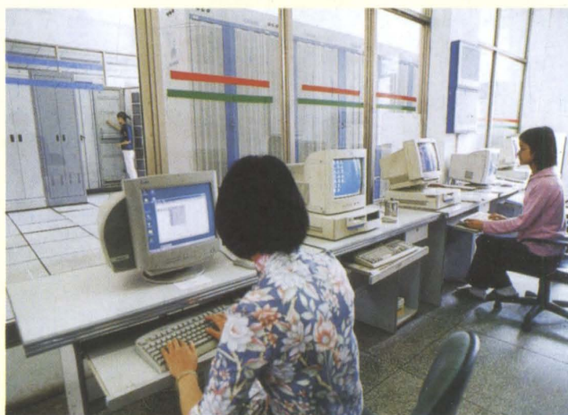
县电信局程控机房
