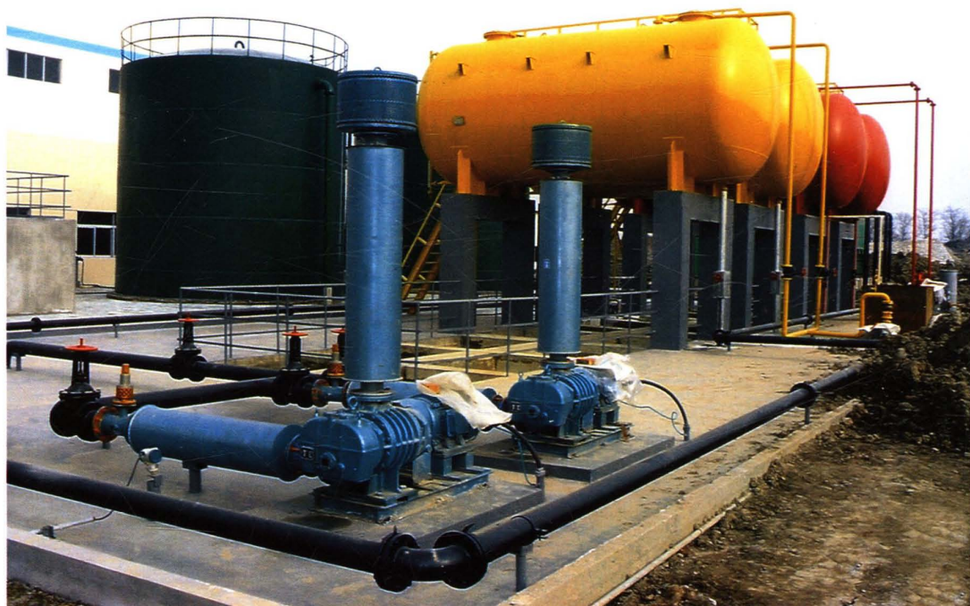
常州新港热电有限公司生产区一瞥
