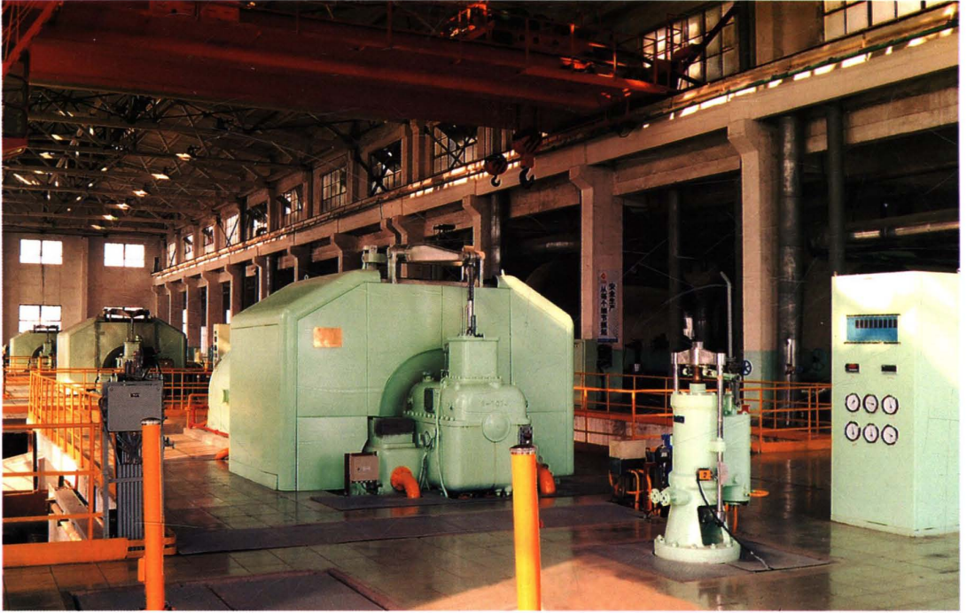
金坛加怡热电有限公司发电车间
