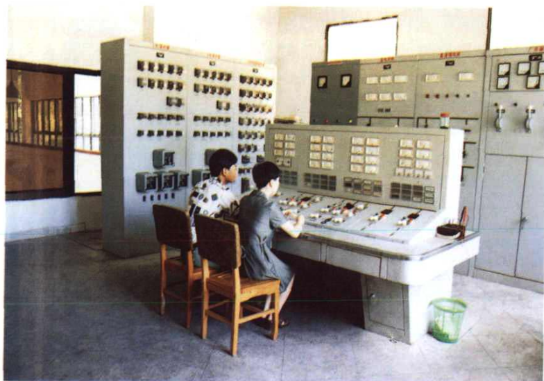
水电站中央控制室
