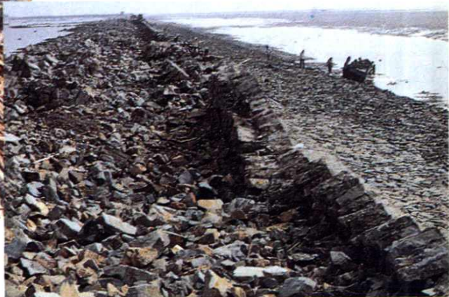
丁山一期围垦工程主堤坝被毁情景
