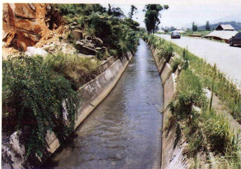
陶溪引水渠道
