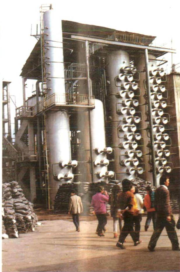
△ 邻水氮肥厂合成塔
