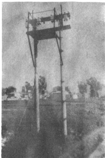
建叻线路始杆（建水城南）P0001 舒予明 摄
