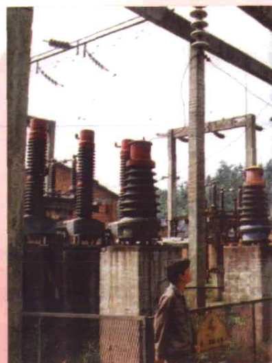
矿总降变电所一角
