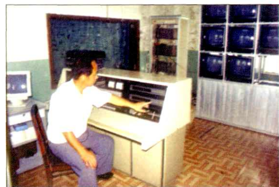
镇广播电视站机房
