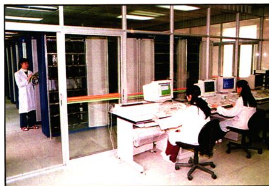
增城县邮电局程控交换机房
