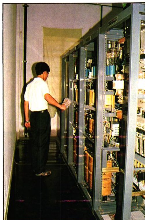
新塘邮电分局电力室
