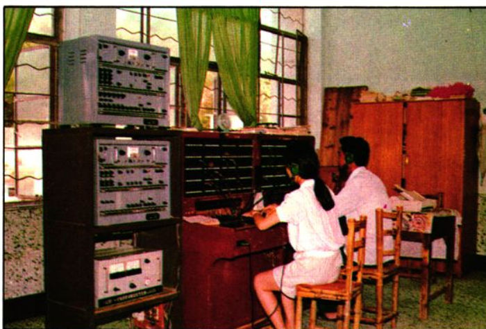
小楼邮电支局话务室
