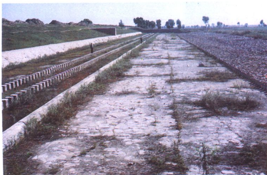
马虎山分洪堰
