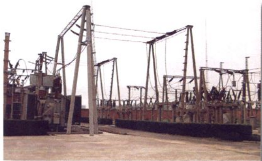
110千伏温县变电站
