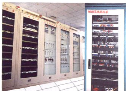
MIS系统机房
