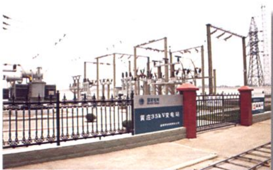
35千伏黄庄变电站
