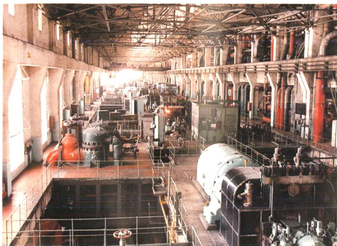
石家庄热电厂汽机车间一角
