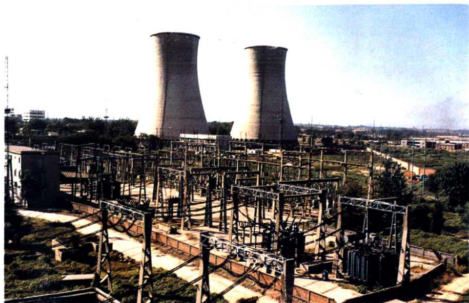
石家庄热电厂升压变电站外景
