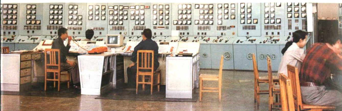
石家庄热电厂主控制室一角
