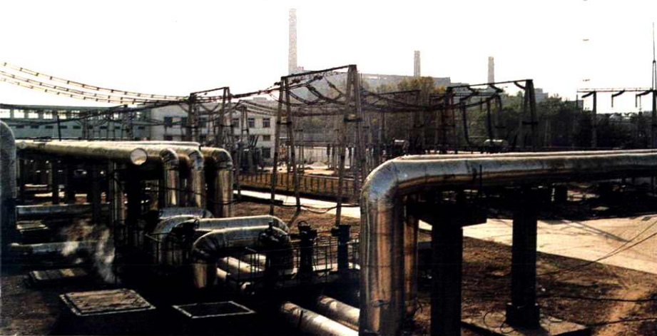
石家庄热电厂供热管道一角
