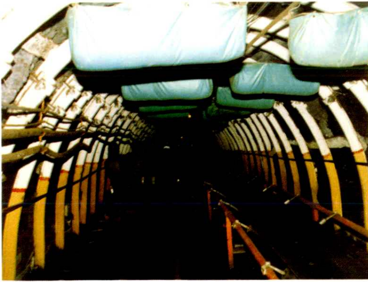
大雁矿务局一矿井下防 火水帘
