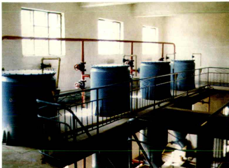
包头矿务局化工厂污水 处理设施
