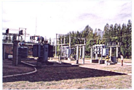
输变电力工程
