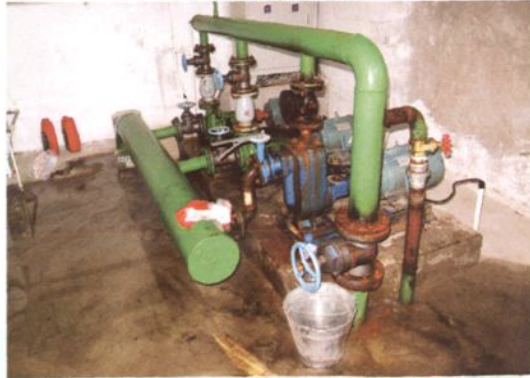
嵯岗镇自来水机井房
