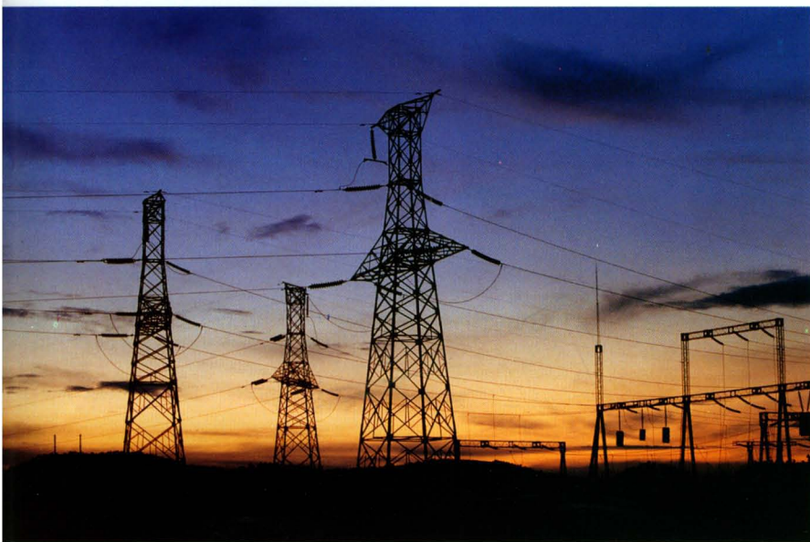
◀ 南宁供电局大沙田 220 千伏变电站外景
