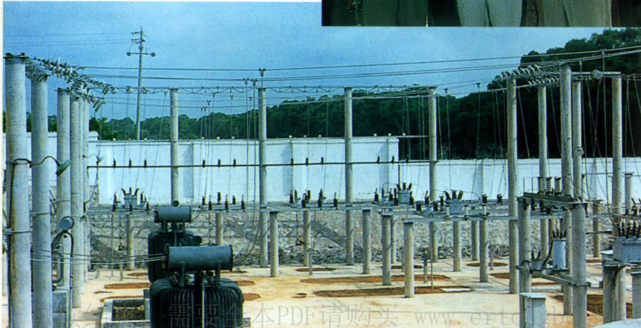
◀武鸣县太平变电站
