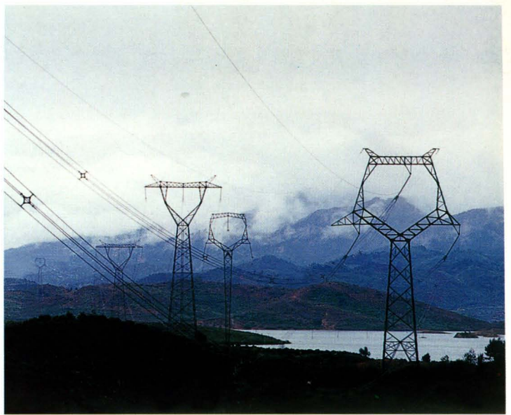
▲南宁供电局 500 千伏超高压输电线路
