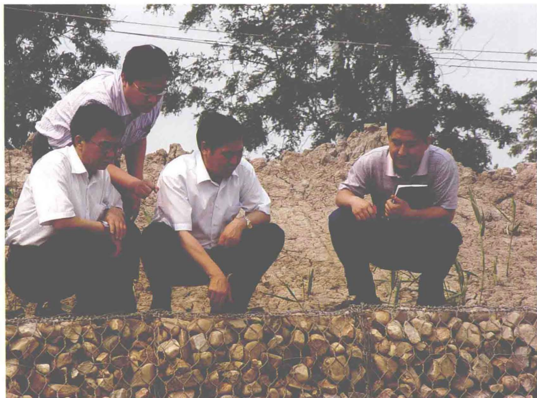
▲2009年6月15日，东丽区区委书记张有会（前中）、副区长王连成（前左）视察东减河治理工程
