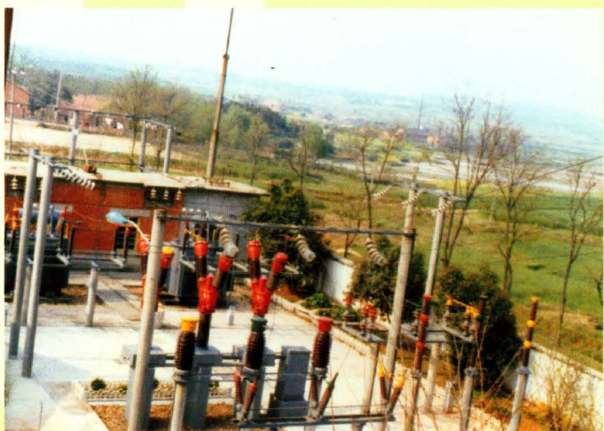
长岭变电站（1965年）
