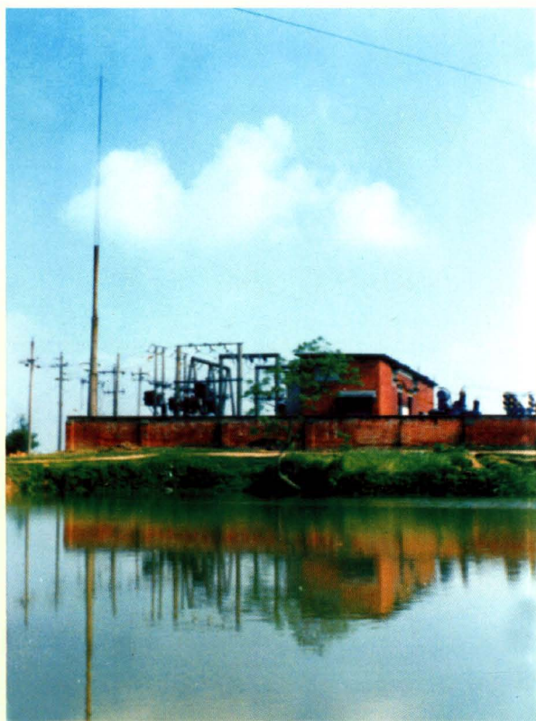
蔡家畈变电站（1964年）
