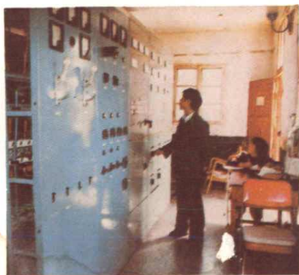
三月三变电站中控室
