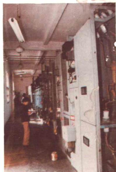
三月三变电站高压室
