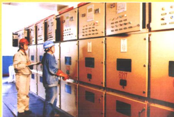
动力车间中心控制室
