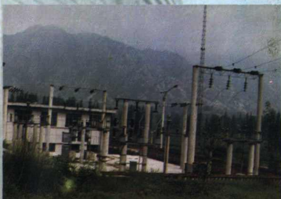
长梁山水电站变电站
