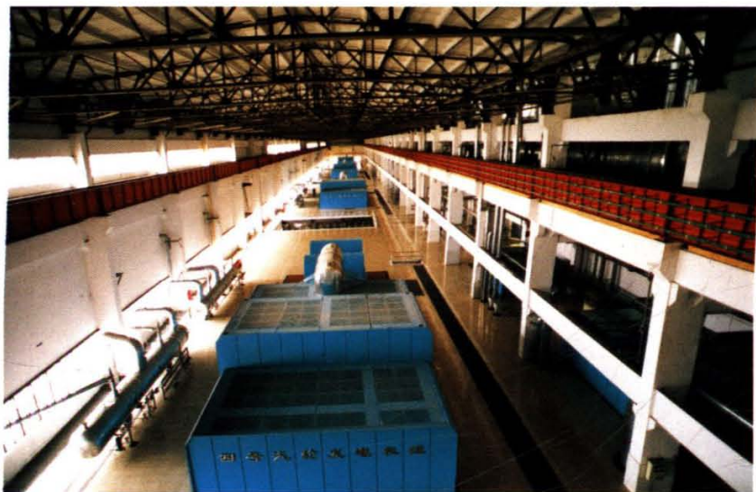
双辽发电厂汽轮发电机房
