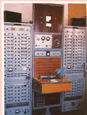
矿务局总调度室电话会议汇接室一角
