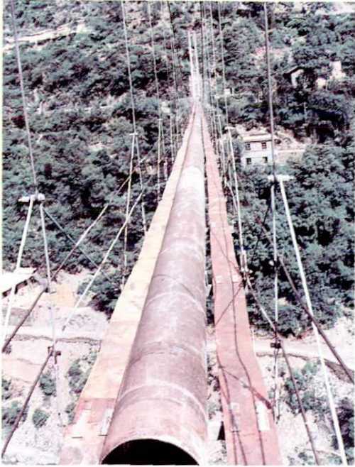
旬阳县平定河水库悬索渡水管
