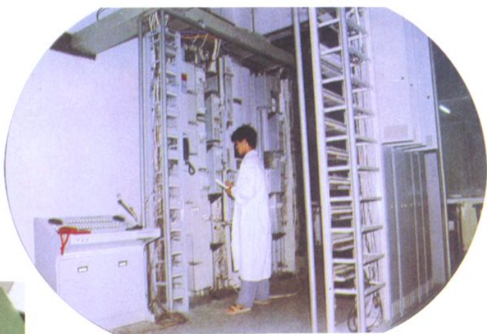
光缆传输设备
