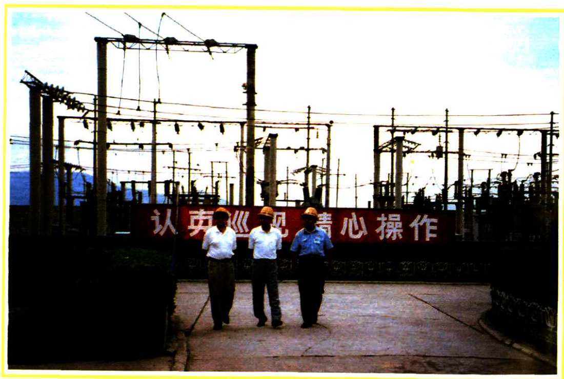
山西省电力局郭连邦总工(中)、晋城供电公司宋晚和书记(左一)视察高平 110 千伏变电站
