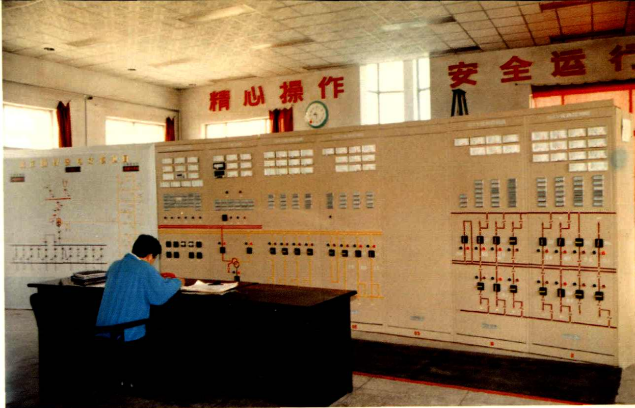
北庄变电站主控室
