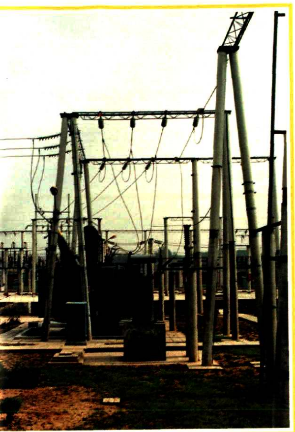
北庄 110 千伏变电站外景
