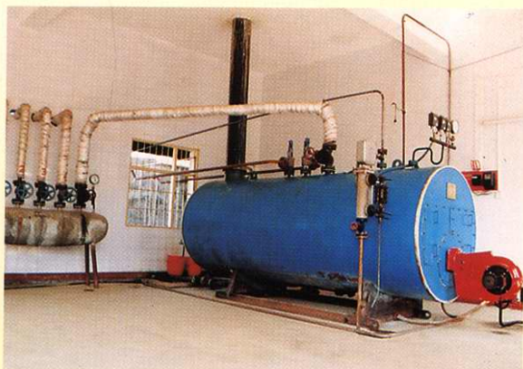
自动燃油锅炉
