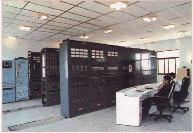
▲ 变电站控制台
