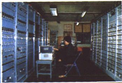
70年代的960路微波通信。图为 建在密县山洞里的微波通信机房
