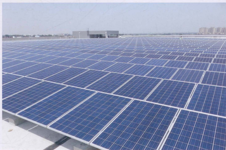
扬杰电力光伏电站
