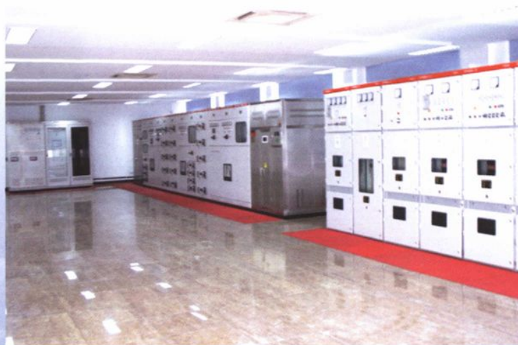
2003年建成的10千伏 配电站
