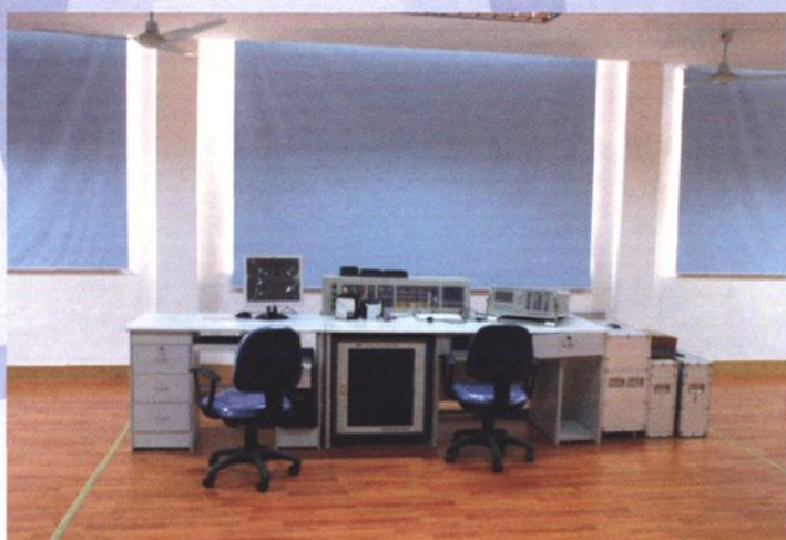
电测仪表实训室
