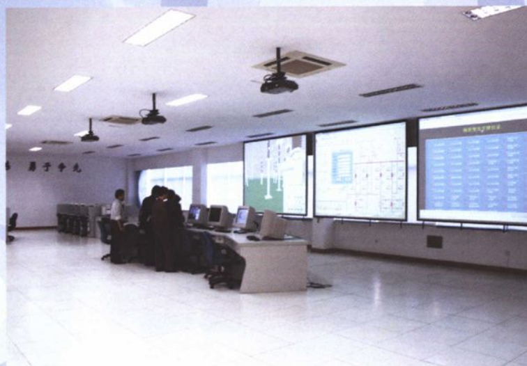
2003年建成的500千伏 变电仿真室
