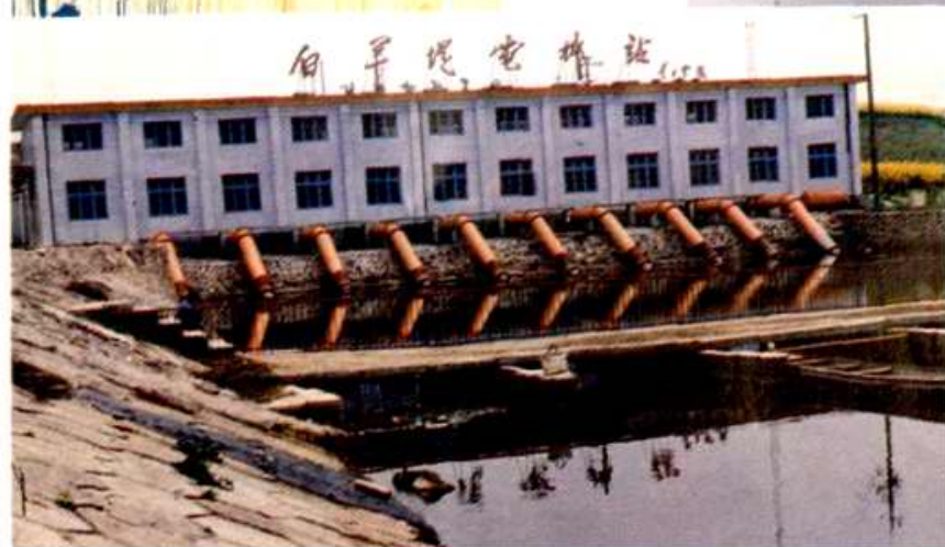
白羊堤电排站
