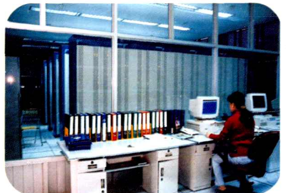
程控电话机房
