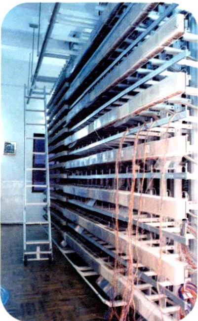
程控电话配线架一角
