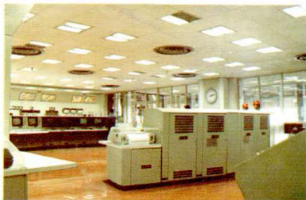
电厂主控机房
