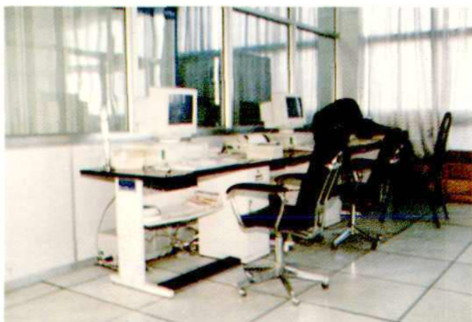
邮电局程控机房
