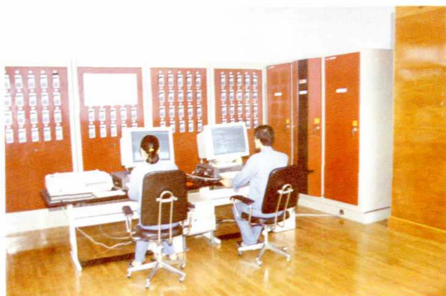
二期工程控制室
