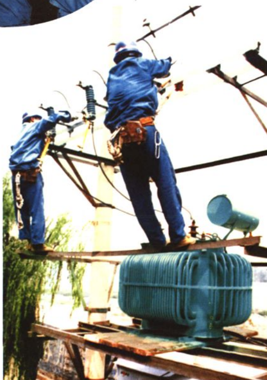
▲ 变电运行班人员正在作业
