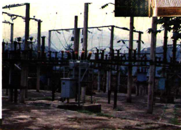
◁ 城区 35 千伏变电站
