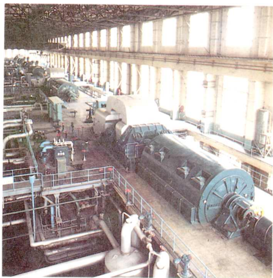
高井发电厂机房
