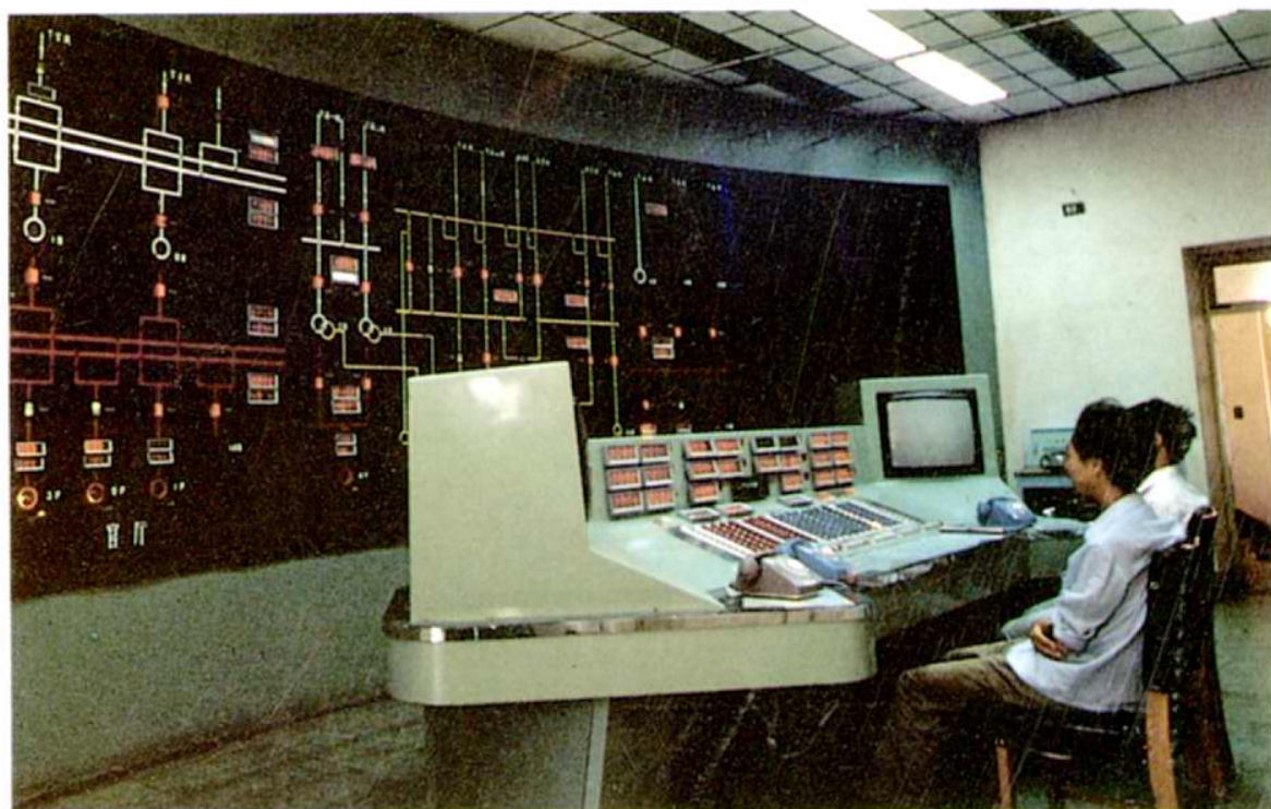
设在下马岭水电站的梯级电站集控中心
