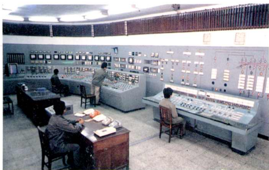
京西发电厂单元控制室
