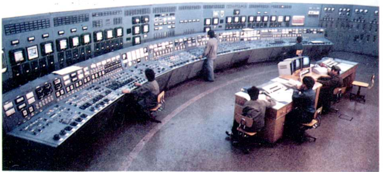
高井发电厂单元控制室
