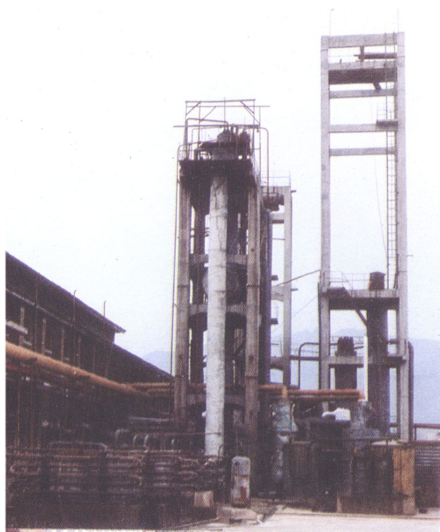
合成、精炼、压 缩工段外部设备
