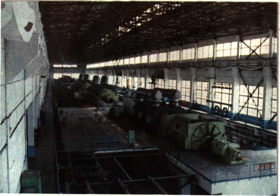
马头发电厂20万瓩机组汽轮发电机房
