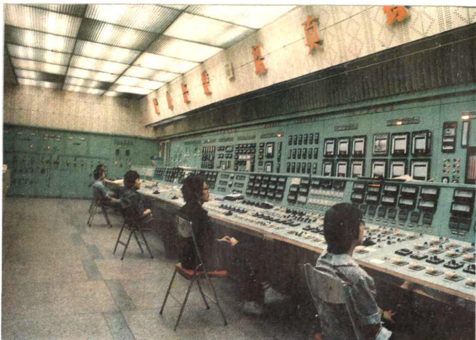
马头发电厂主控制室一角
