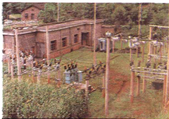
▲ 图8 青山凹变电站
