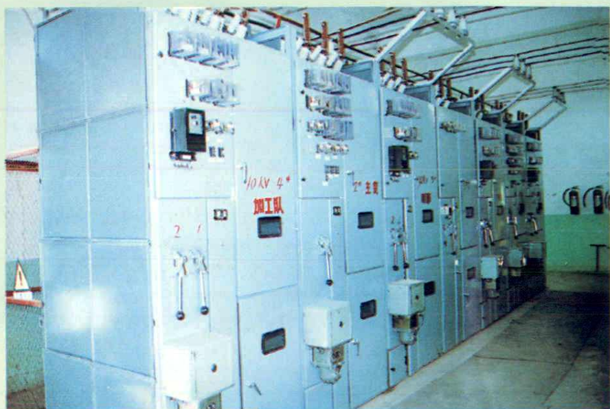
团变电所高压配电屏 (1995年)
