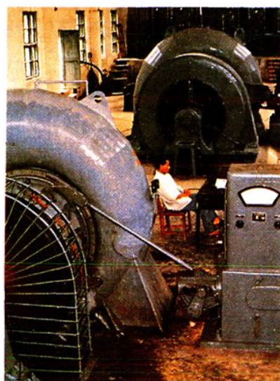
向阳二级电站发电 厂房一角, 装机 3台, 总装机容量 2230千瓦, 年发 电量450万千瓦 小时 (建于1968 年)
