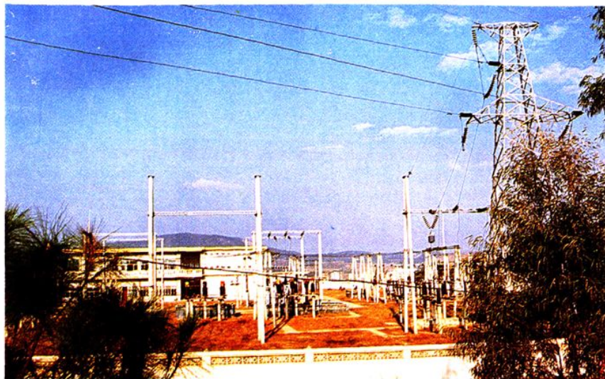
都城110千伏 输变电站外景 (建于1987年)
