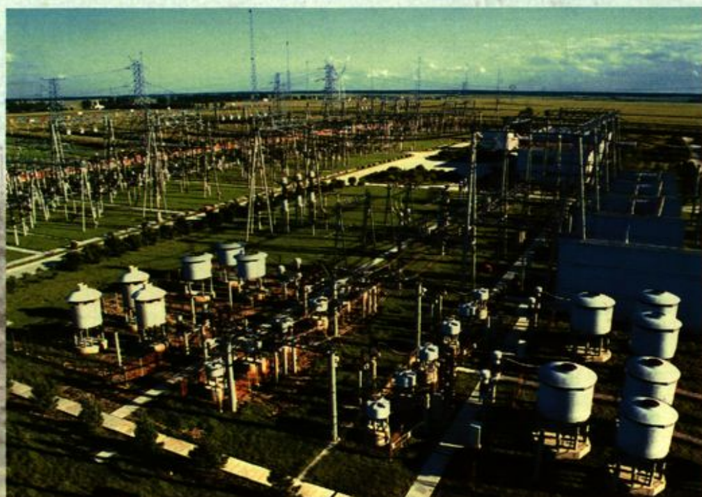
黑龙江省第一座500千伏变电所—哈尔滨哈南变电所
