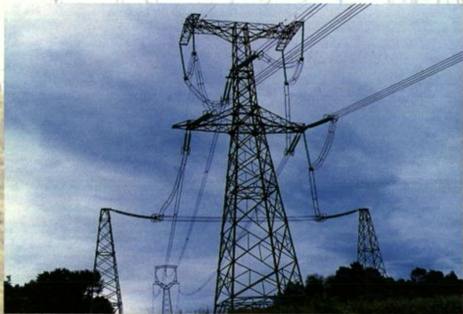
500千伏七台河—方正—哈尔滨输电线路方 哈段换位塔
