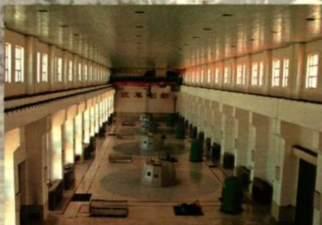
莲花水电站水电机组
