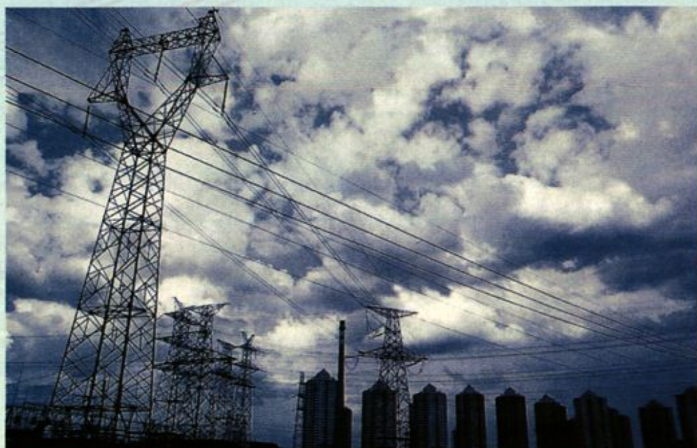
大庆220千伏输电线路
