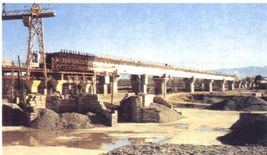
宝中线“单线铁路预应力混凝土箱形连续梁多点顶推法成套技术”，获中国铁道建筑总公司科技进步一等奖、铁道部科技进步二等奖。
