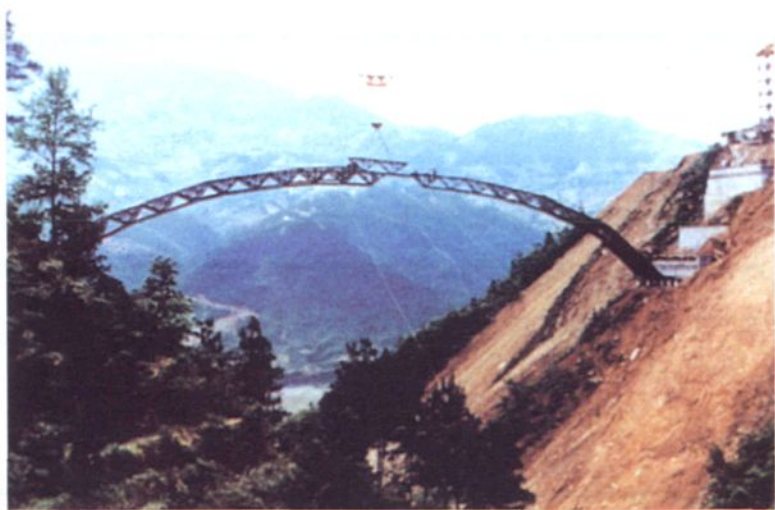
可调曲率桁式拱架 架设箱型混凝土拱桥施 工技术获中国铁道建筑 总公司科技进步一等奖
