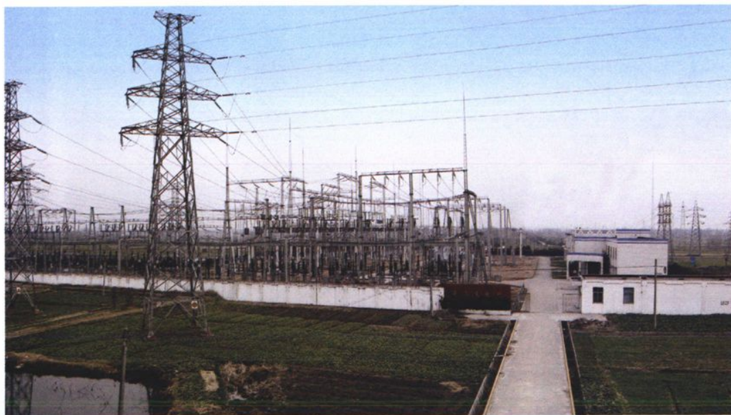
2002年220千伏赛庄变电所全景
