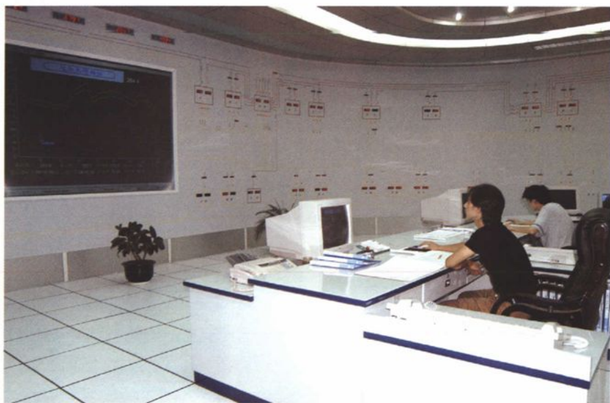
丹阳市供电 局电网调度中心 (2002年9月摄)
