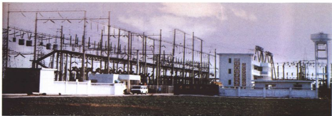
220千伏丹阳变电所在江苏省电力公司2000年度一流变电所评比中荣获第一名
