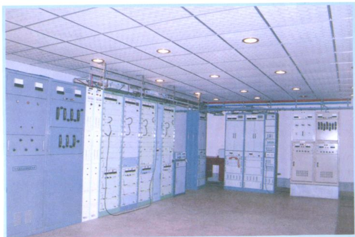
△寿光市微波站机房
