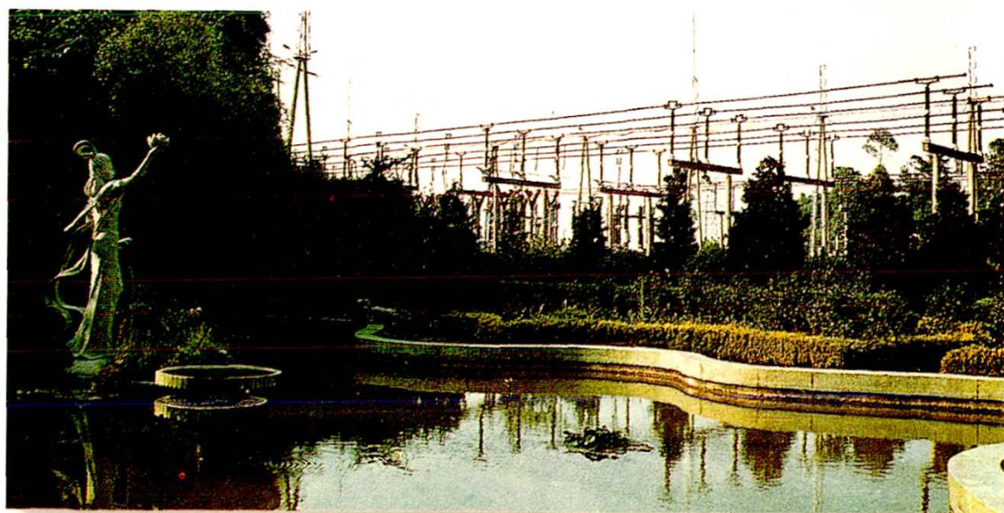
泸州地区最大的变电站——220千伏林庄变电站
